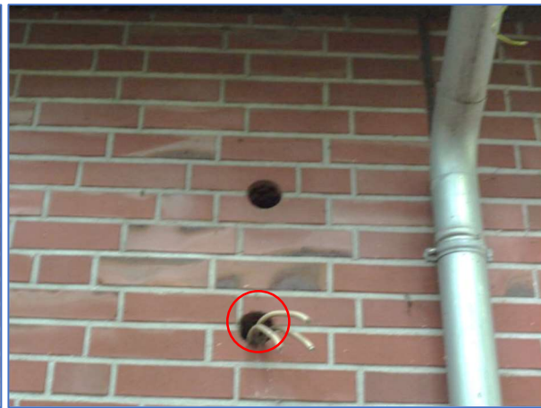
Abb. 11 Brutplatz eines Nischenbrüters in einem Kabelschacht.
