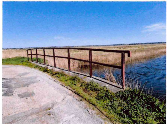
0001M_H2024_GELÄNDER_FALSCHER GELÄNDERTYP VERALTET
